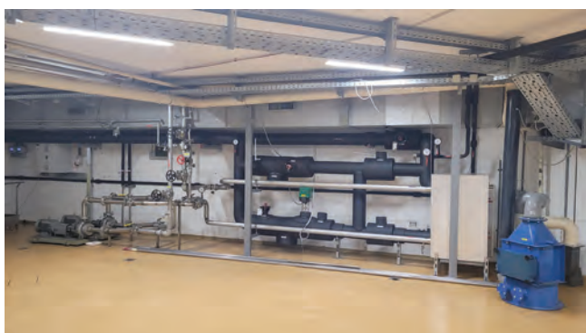
Slika 4: Nove cevi sekundarnega hladilnega kroga
